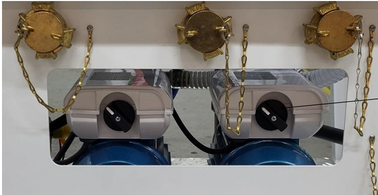
Interruptor de la bomba de aguas residuales
