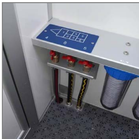
Abb. 123 Anschlüsse der Kammern 4-6 an das Abwasserfiltersystem
