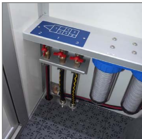
Illustration 121 Raccordement des compartiments 1- 3 au système de filtration des eaux usées
