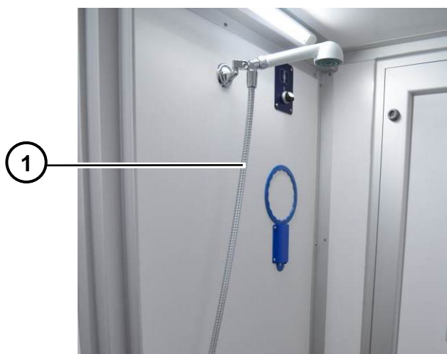
Abb. 135 Tubo flessibile della doccia
