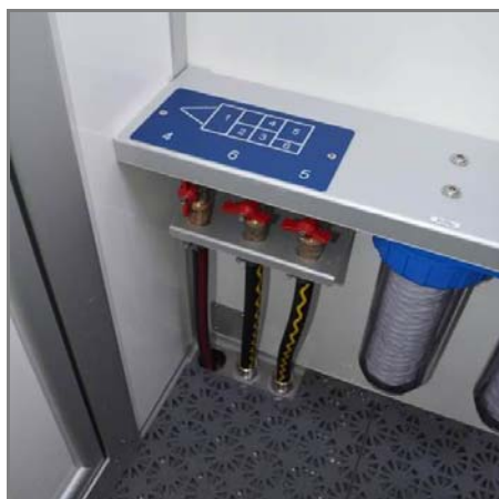
Abb. 123 Collegamenti dei compartimenti 4-6 al sistema di filtraggio dell'acqua di scarico
