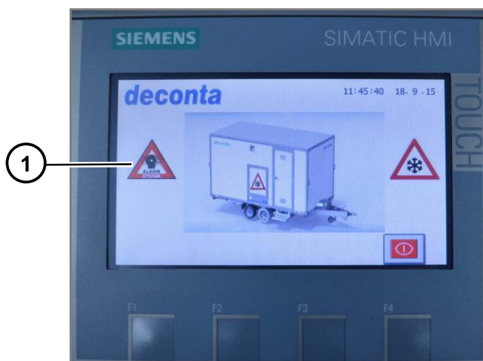
Abb. 100 Visualizzazione dell'impianto di allarme
