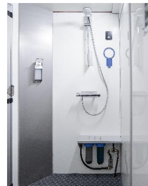
Dusche mit 2-stufiger Abwasserfiltrierung
