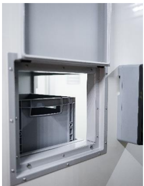
Schleuse für Wechselkleidung
